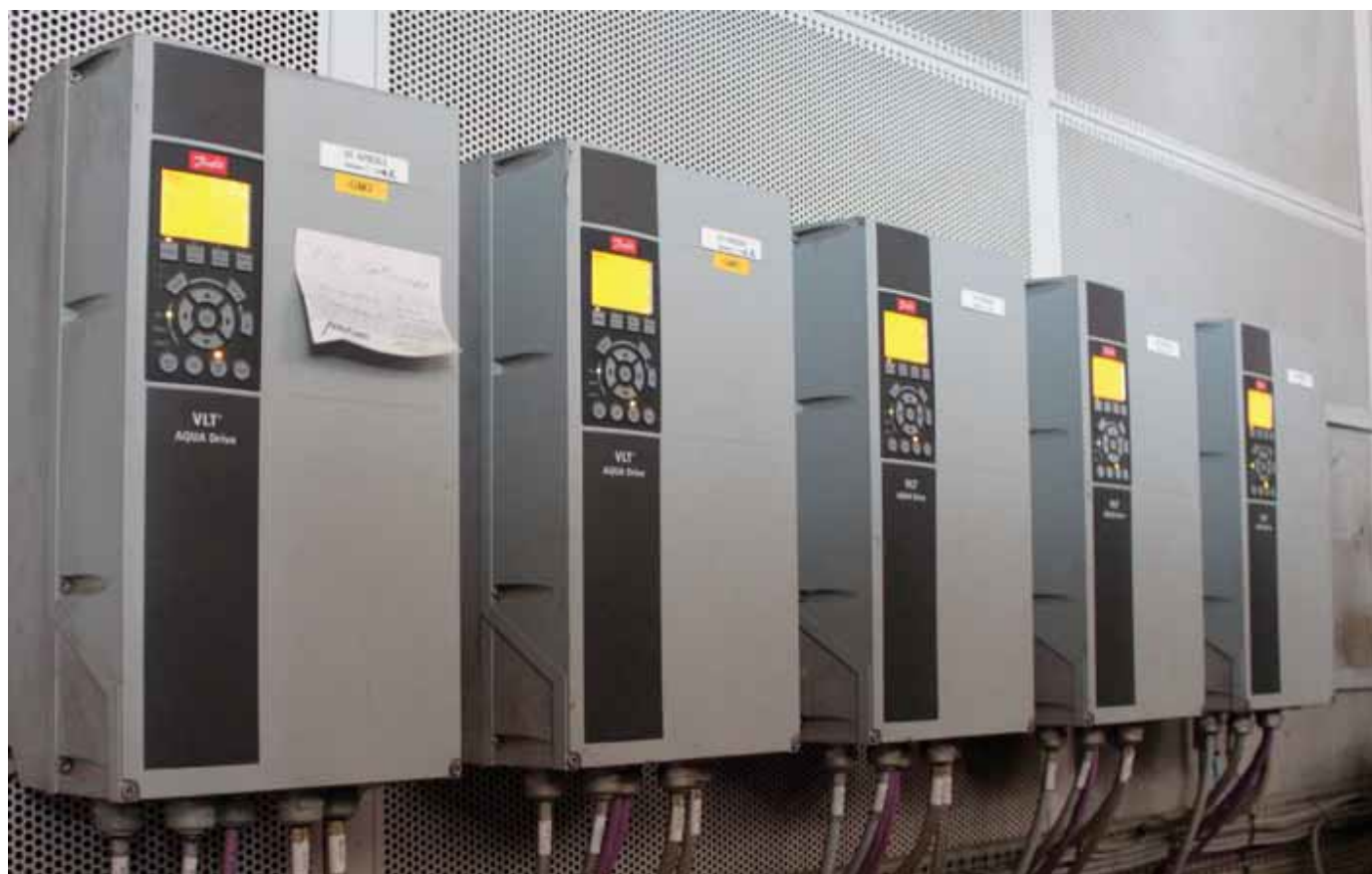
Метановый силовой генератор: VLT® AQUA Drive контролируют вентиляторы и усилительные установки.
