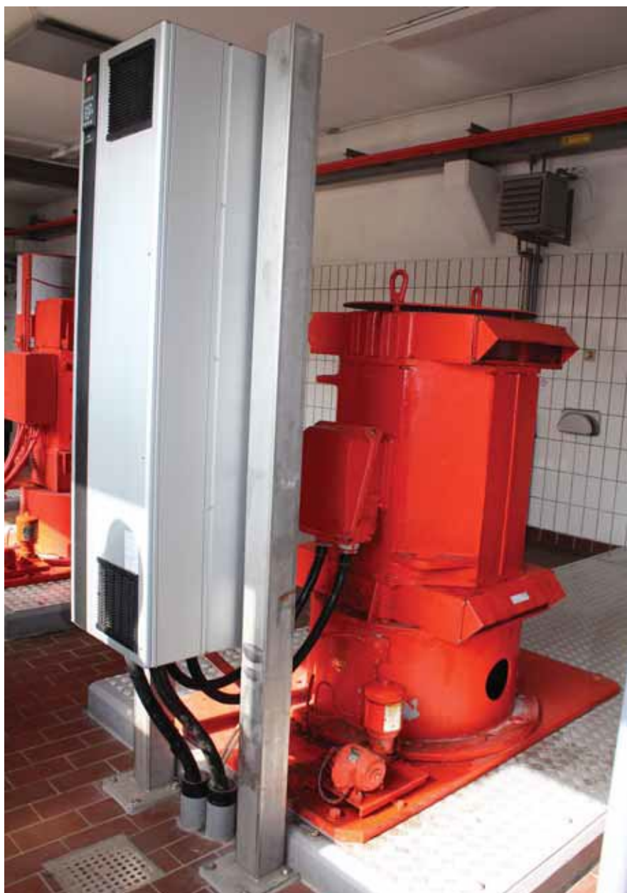
Насосная станция: Преобразователь частоты VLT 160 KВт исполнения IP54 контролирует насос весом 1,25 т
